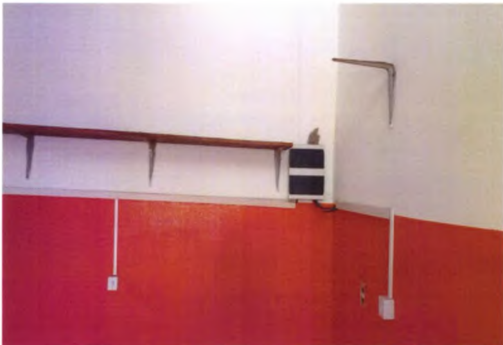
Foto 18: Prateleiras de armazenamento e quadro de distribuição de energia.
