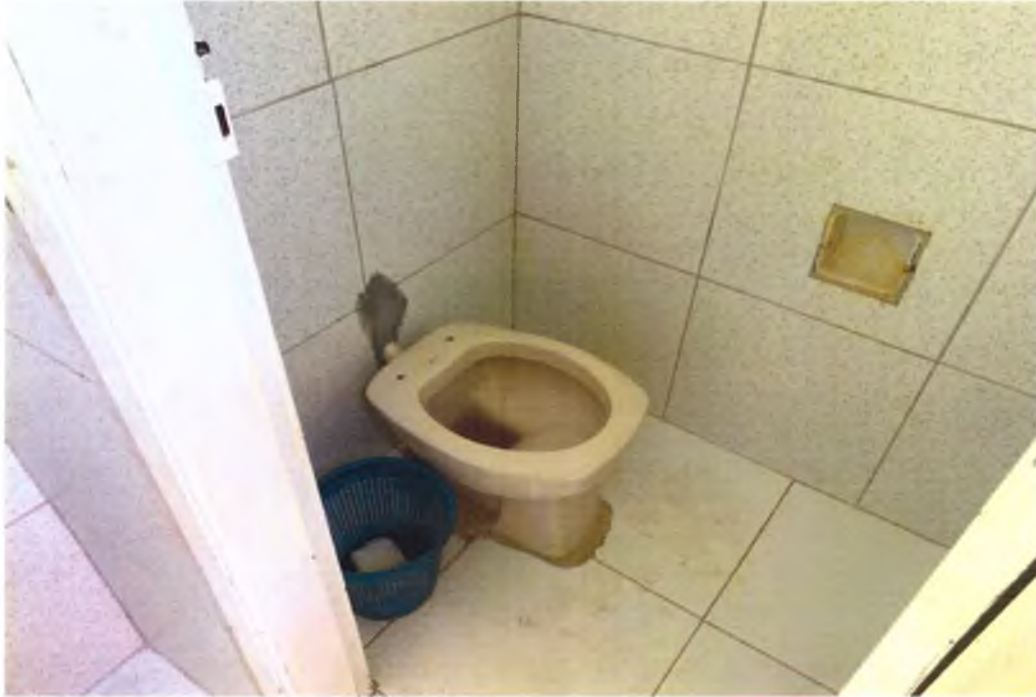
Foto 13: Banheiro feminino – vaso sanitário.
